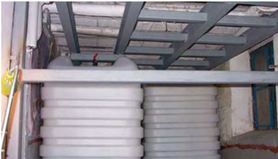
ABBILDUNG 15: HEIZÖLTANKANLAGE MIT AUFTRIEBSSICHERUNG (QUELLE: HOCHWASSERSCHUTZFIBEL, 2018)
